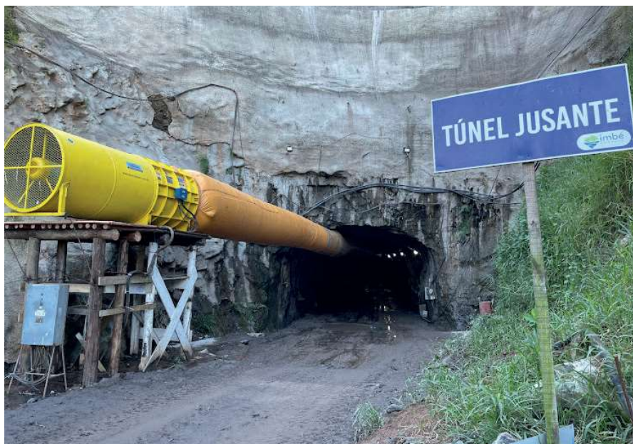
Ventilador primário de alta pressão para abertura do túnel jusante de 1320 metros
